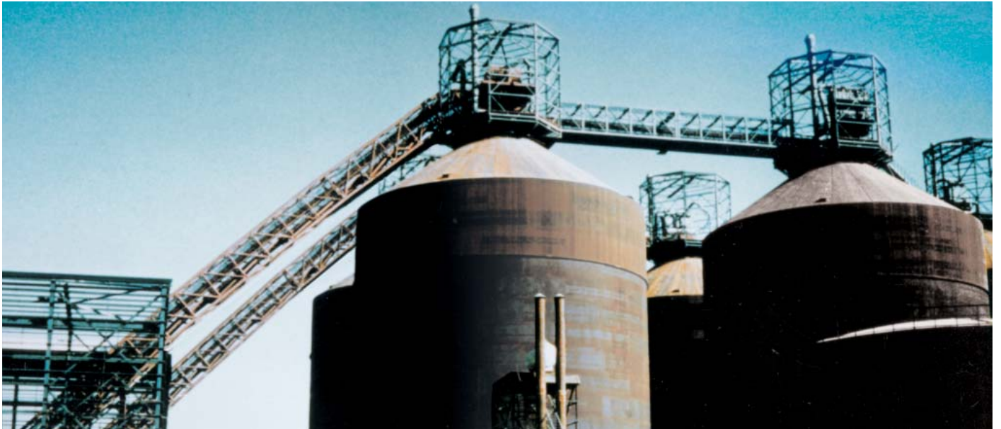
鋼製プレートサイロへの搬送
