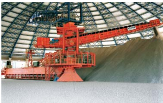
石灰石用の円形貯蔵設備の中のスタッカー及びブリッジ型スクレイパーリクレイマー
